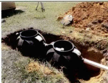
Detalhe do conjunto fossa séptica (fossa séptica e filtro anaeróbico).
